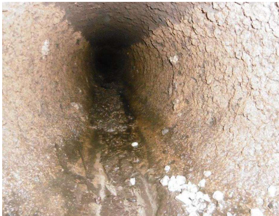
Etat de la canalisation initial
