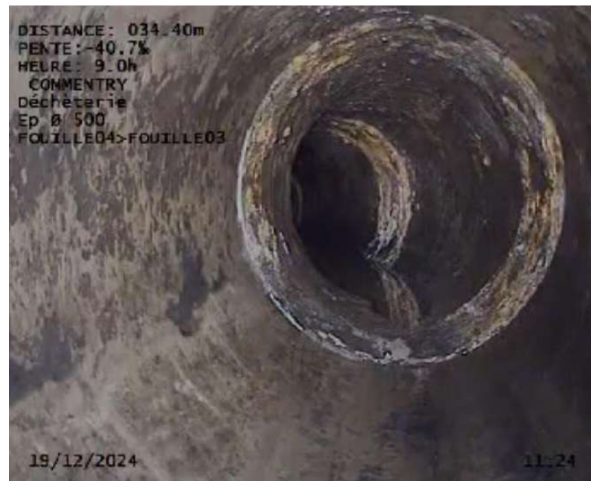
Etat de la canalisation après hydrocurage et fraisage des singularités
