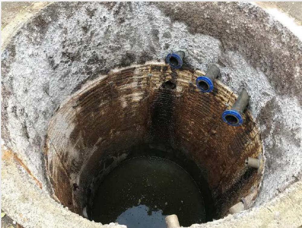
Corrosion du béton par les effets de l' H_2S
