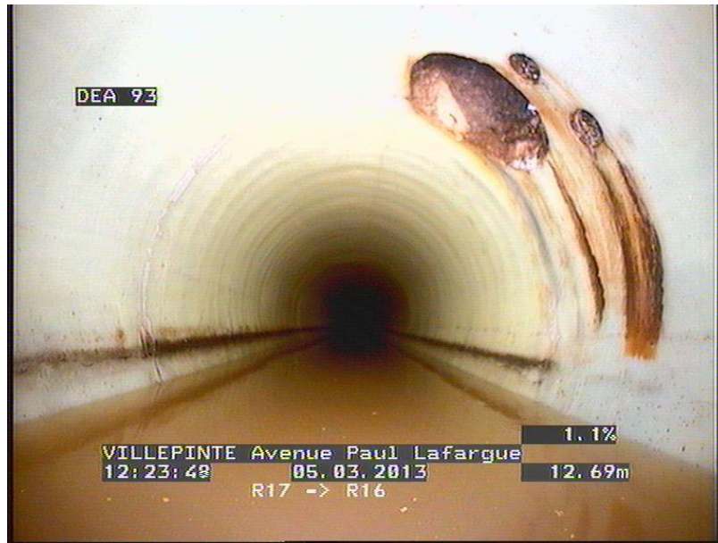
Trous dans le revêtement
