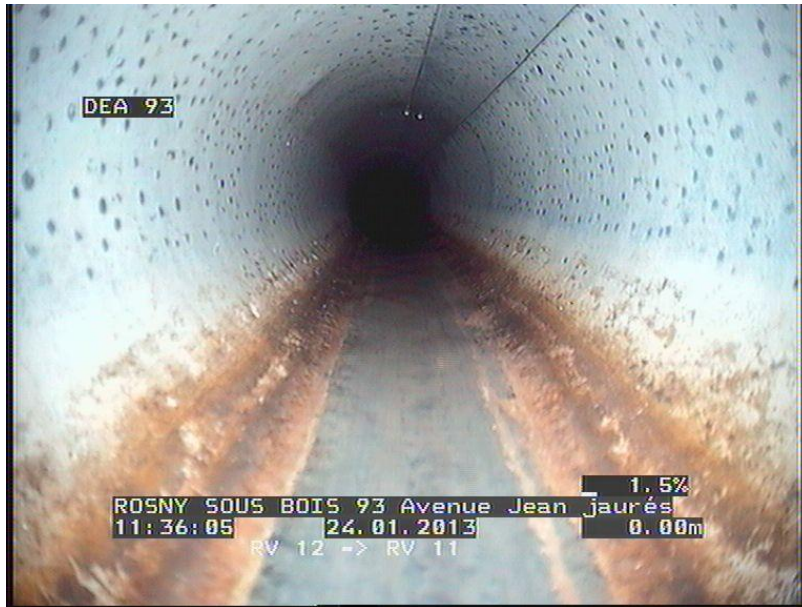
Décoloration du revêtement
