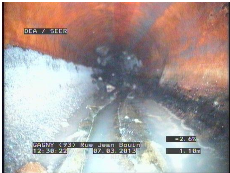
Détachement du revêtement
