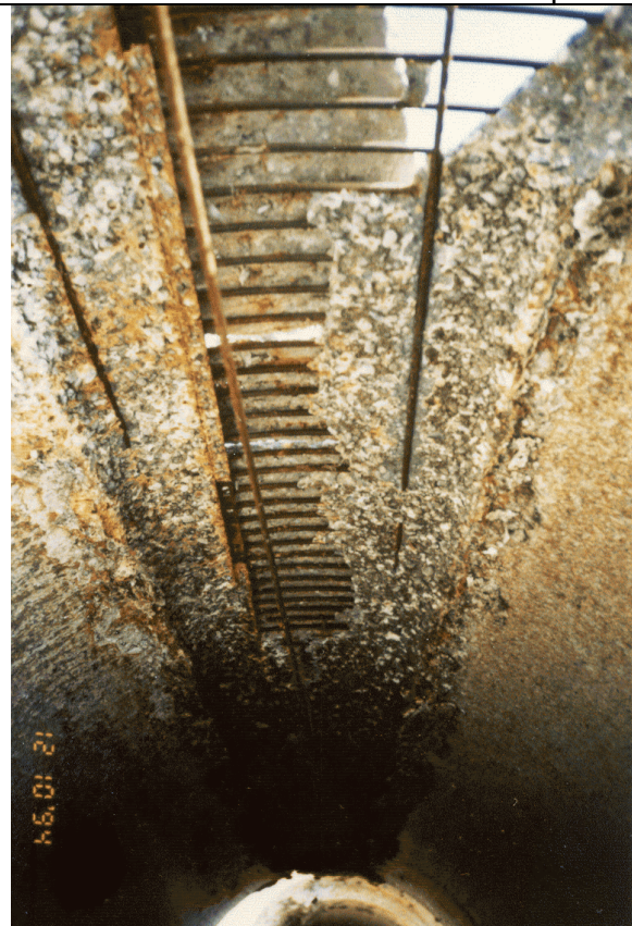
Dégradations de la voute / H 2 S
