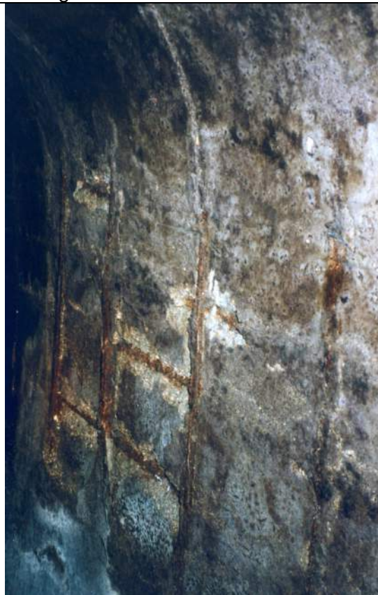
Dégradations de la structure
